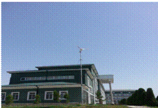
Fig. 1. VEU-3000 installed in JizPна территории ДжизПИ
